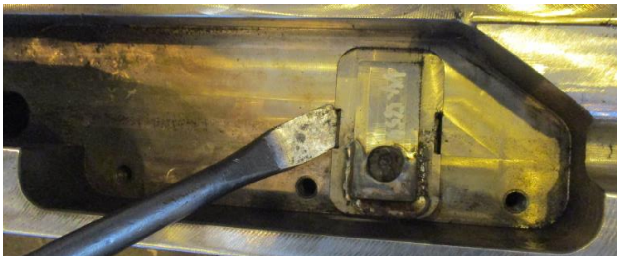
Do vybrání v pojistném plechu vsunout montážní páku a plech lehce nadzvednout střídavě na obou stranách
